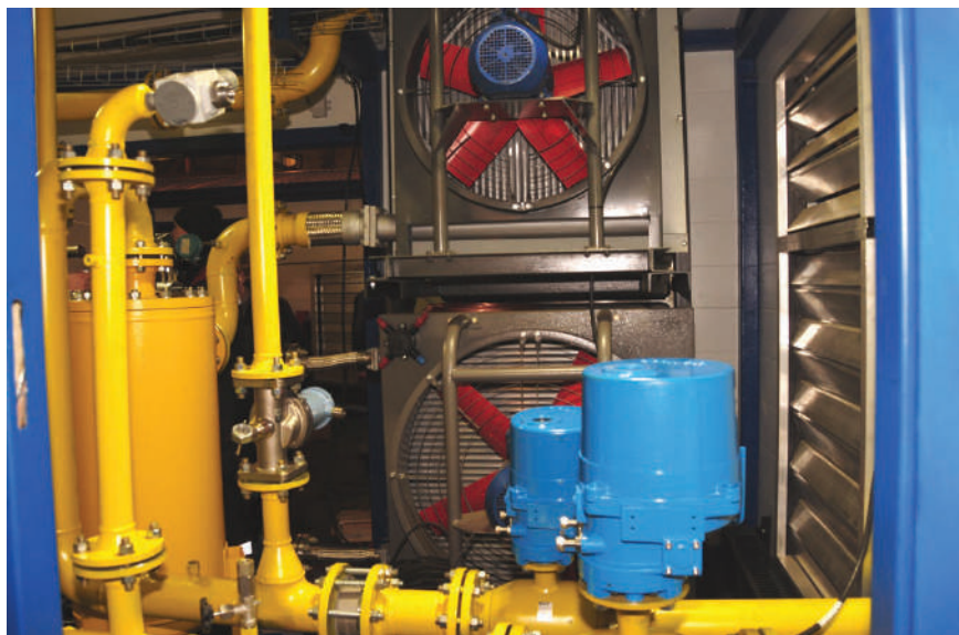
Внутри газовой станции
