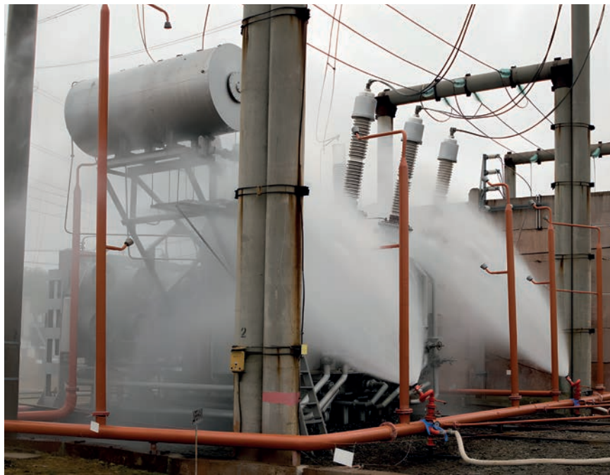
Рис. 3. Пример использования РУП для защиты трансформаторной подстанции
