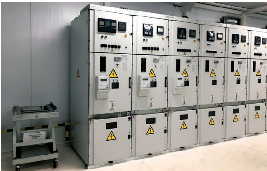
Рис. 1. Общий вид распределительного устройства КТП на базе КРУ Каскад
