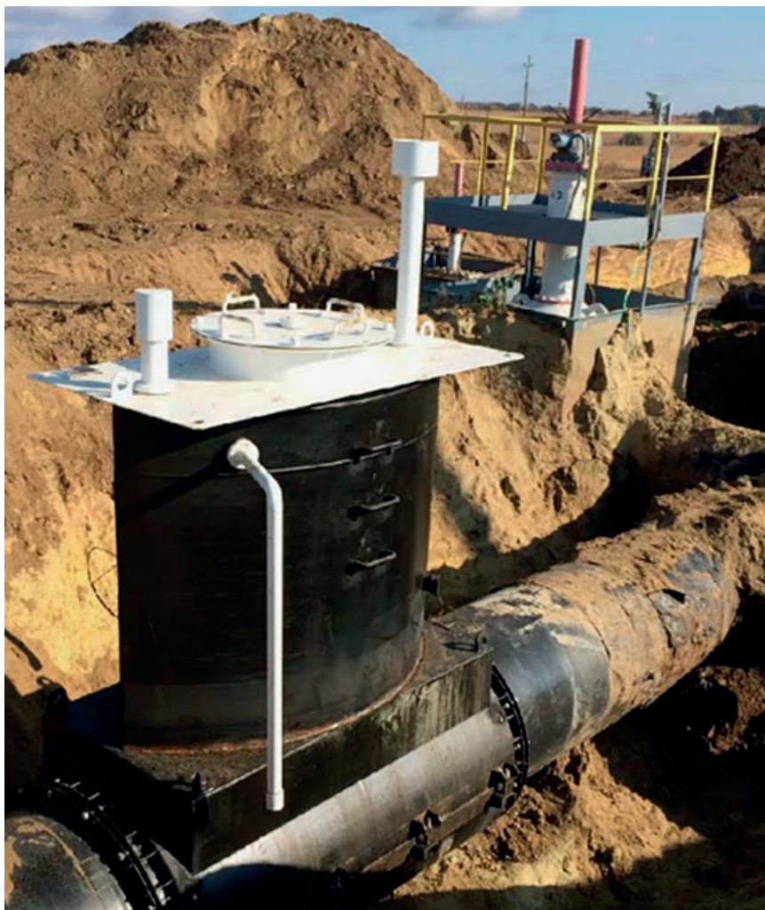
Проект: Техническое перевооружение системы обнаружения утечек Объект: Колодец на трубопроводе
