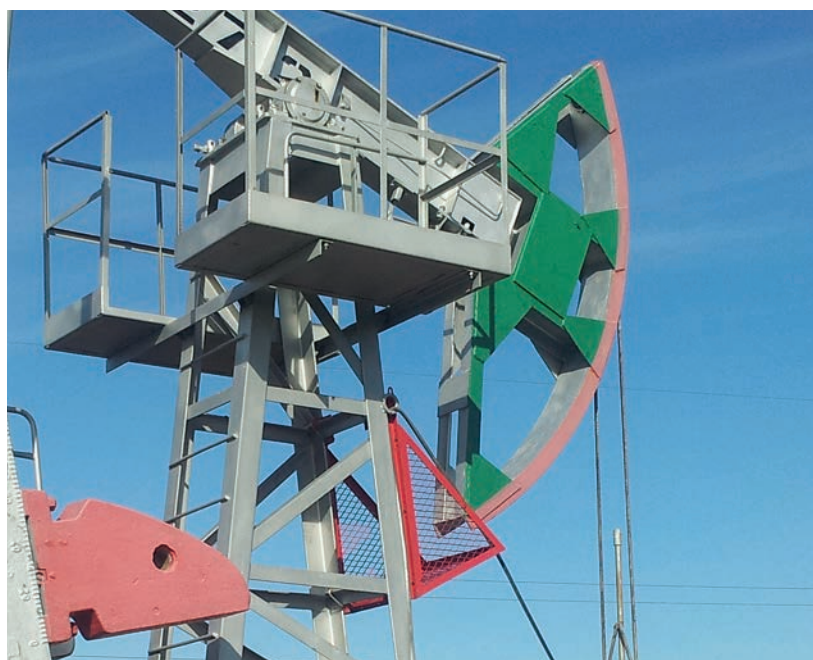
Рис. 3. Привод ПНШ-80 с установленным ограждением головки балансира
