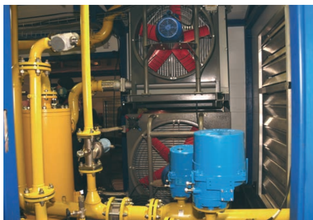
Внутри газовой станции
