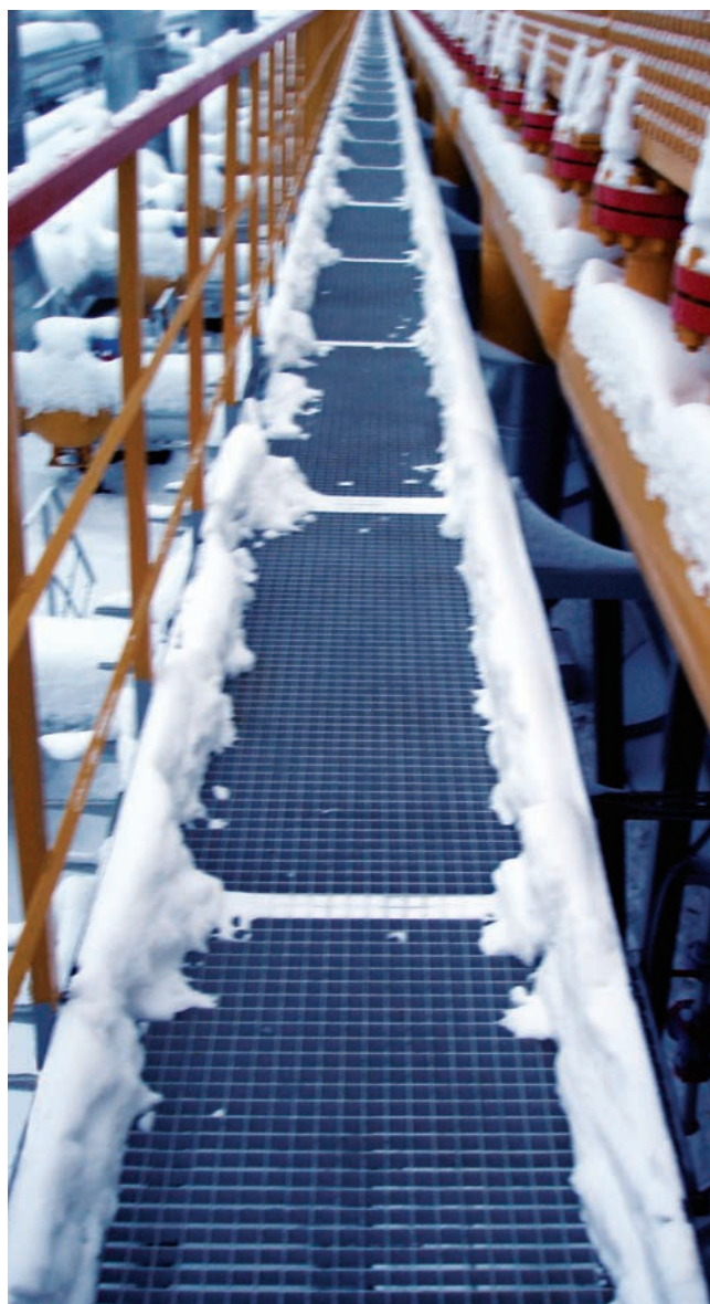
Рис. 2. Состояние ходового мостика из решетчатых настилов
