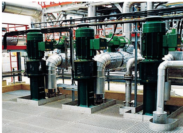
Рис. 4. Площадки обслуживания оборудования
