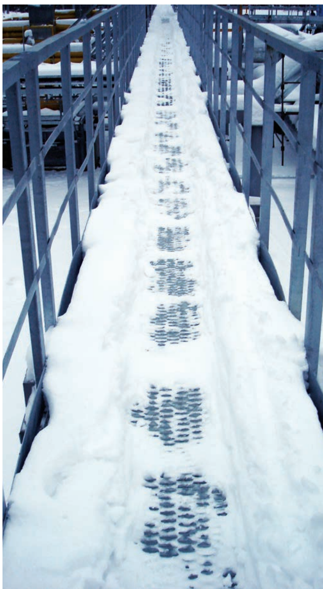
Рис. 1. Состояние ходового мостика из просечно-вытяжного листа
