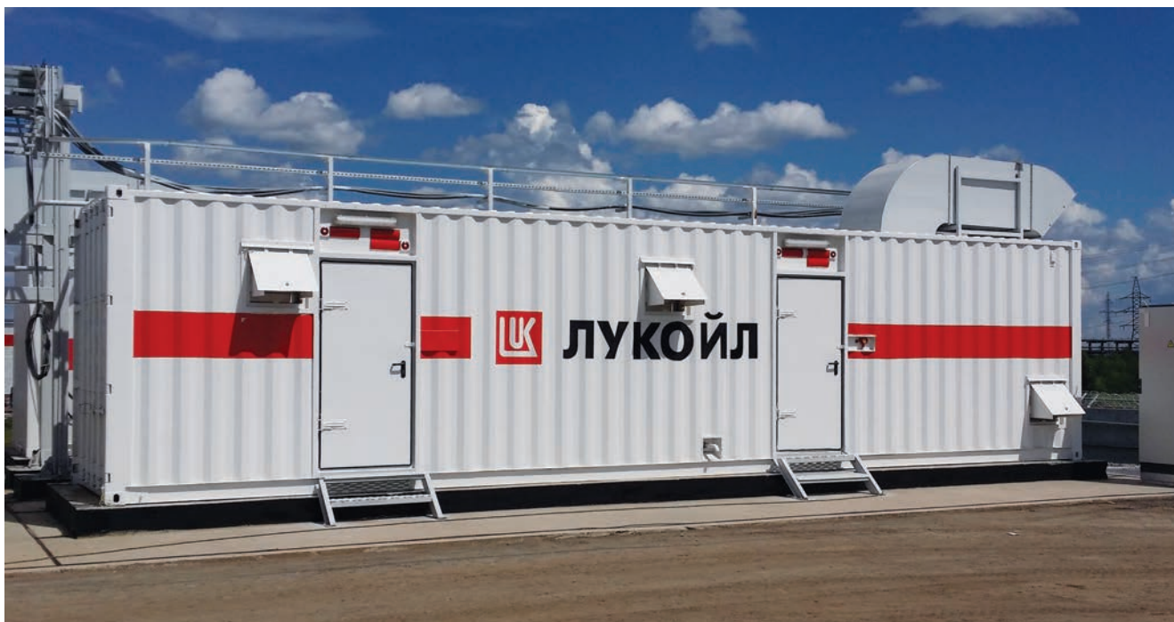
Адсорбционная азотная станция в контейнере
