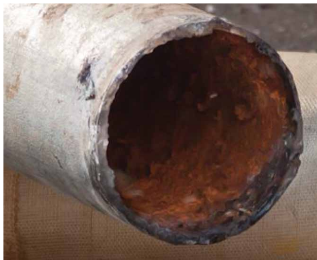
Рис. 1. Коррозионные участки, царапины и риски на стенке труб, вследствие воздействия различного инструмента
