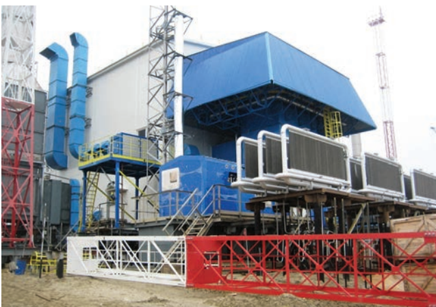
Рис. 6. Конденсаторные блоки систем «ВЕТ» на ГКС Заполярного месторождения
