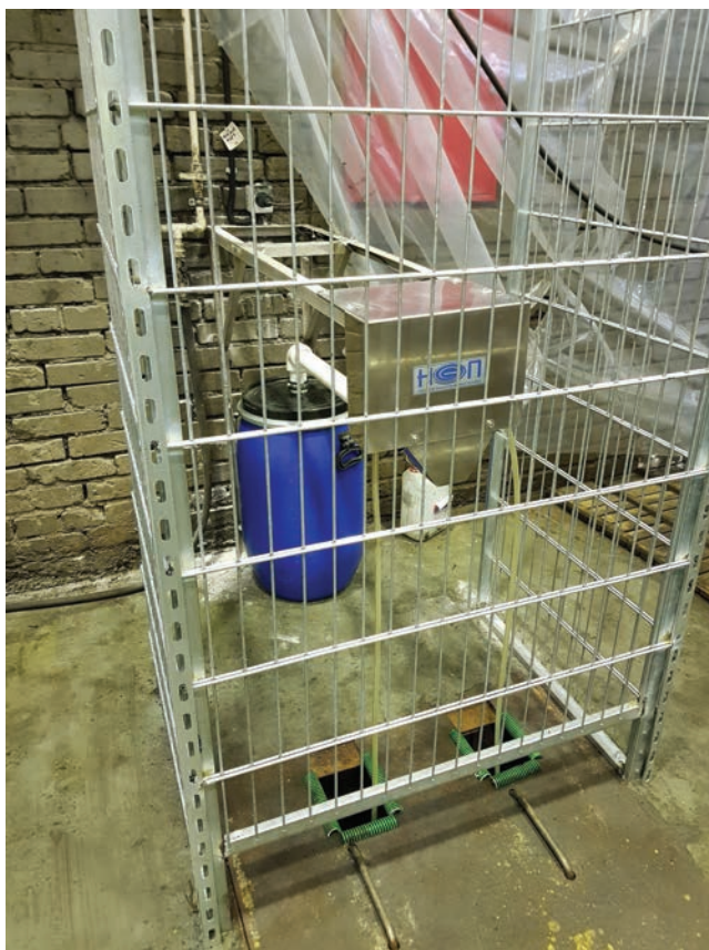
Скиммер 1UV на очистных сооружениях моечного поста депо
