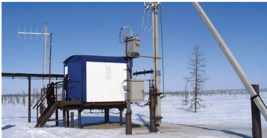
Рис. 4. Блок-бокс электрифицированного КП ТМ
