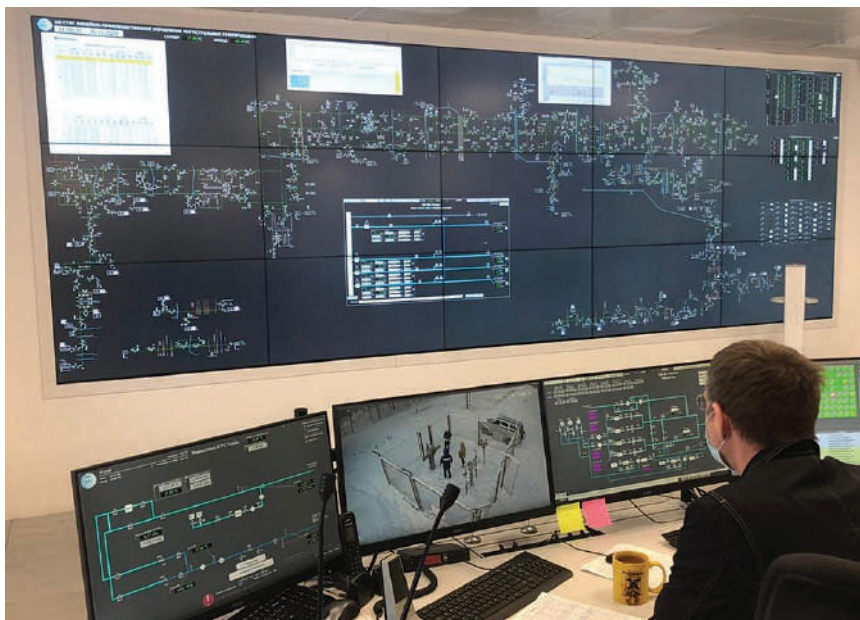
Рис. 9. Пункт управления системы линейной телемеханики
