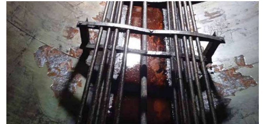
Рис. 8. Фото поверхности металла технологической емкости 100 м³ до ремонтного воздействия
