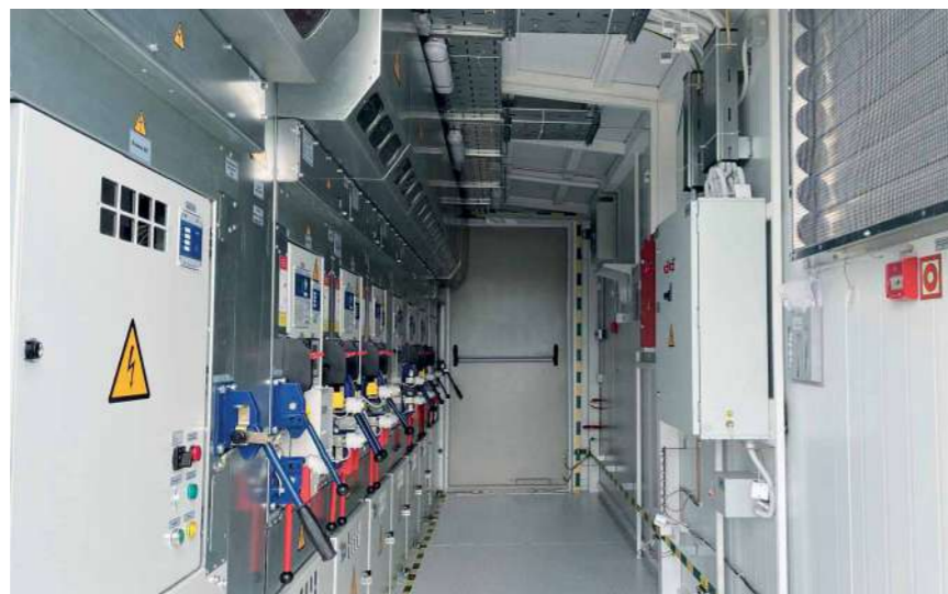
Рис. 1. Современное блочное комплектное распределительное устройство на базе КСО-298
